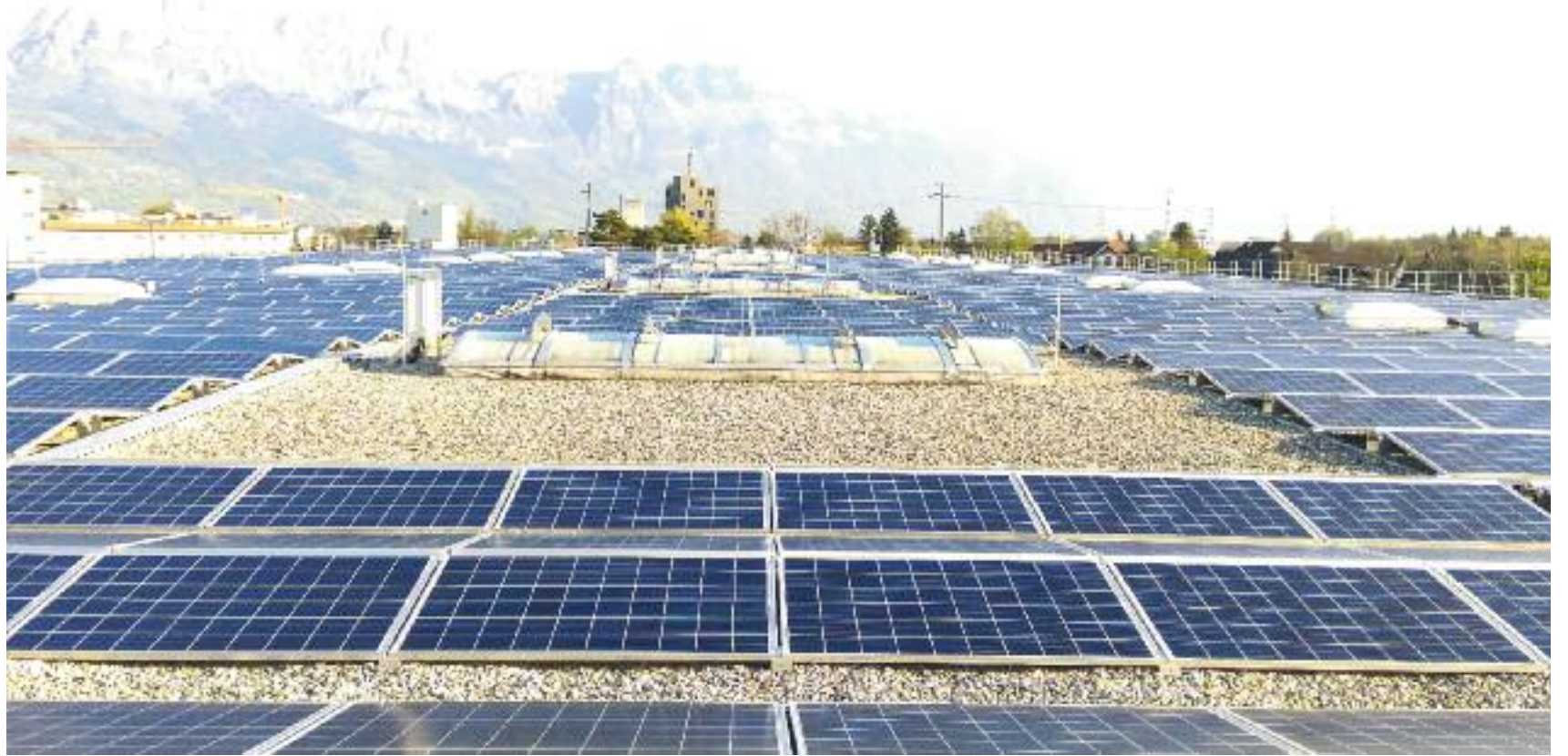
Fast so gross wie ein Fussballfeld: Die 3040 Solarpanels auf dem Dach der Ricambo-Lagerhalle bringen eine Jahresleistung von 770 000 Kilowattstunden. Bild: pd
