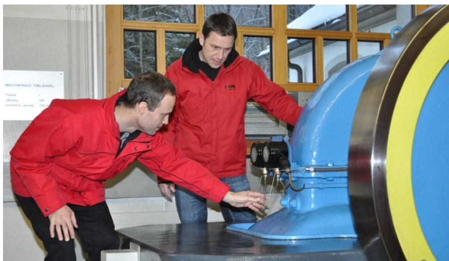
Abbildung: Jürg Göldi und Niklaus Müller von der Wasser- und Stromversorgung bei einer Turbine im Kraftwerk Tobeläckerli
