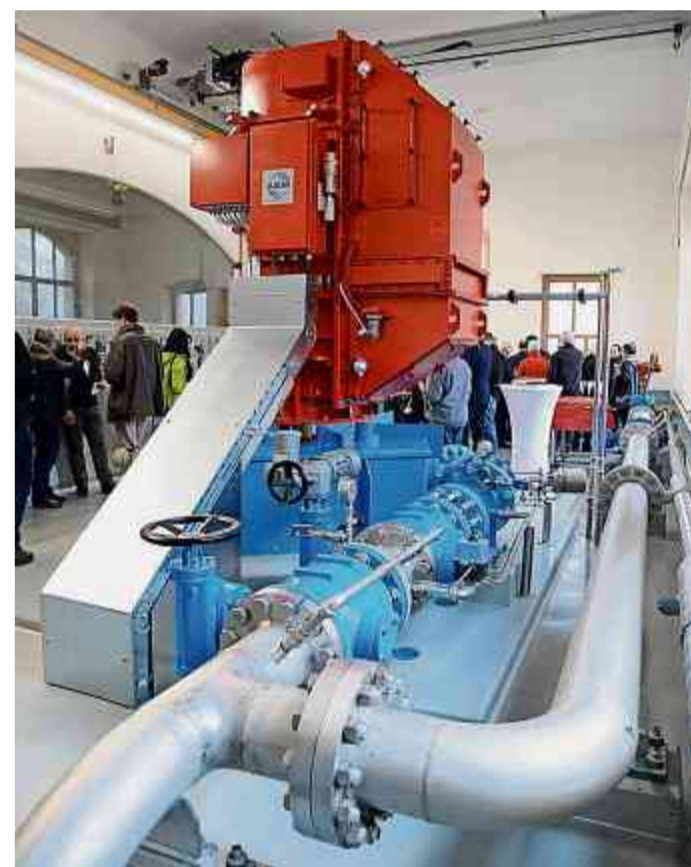
Die neue Turbine im Buchser Trinkwasserkraftwerk Tobeläckerli.
